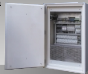
Unterverteiler in Funktionserhalt 30 Minuten
